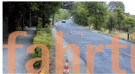
vorher Abgenutzter und verbrauchter Straßenaufbau, fehlende Entwässerungseinrichtungen, unzureichende Gehweganbindung aus Splitt und Schotter, nur bei guten Witterungsverhältnissen begehbar
