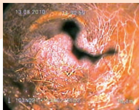
vorher Wurzeleinwüchse verstopfen den Abfluss
